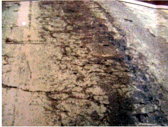
سطح طريق به تشققات متعددة
