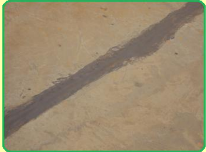
الصورة توضح فاصل تمدد بالسطح .
