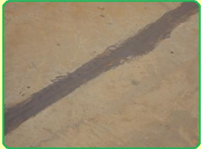
الصورة توضح معجون فواصل التمدد بالسطح .
