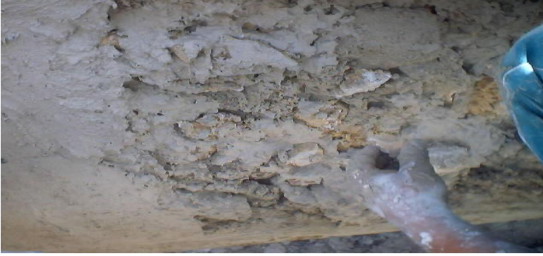
عملية التنظيف الشقوق و إزالة الطبقات المتآكلة
