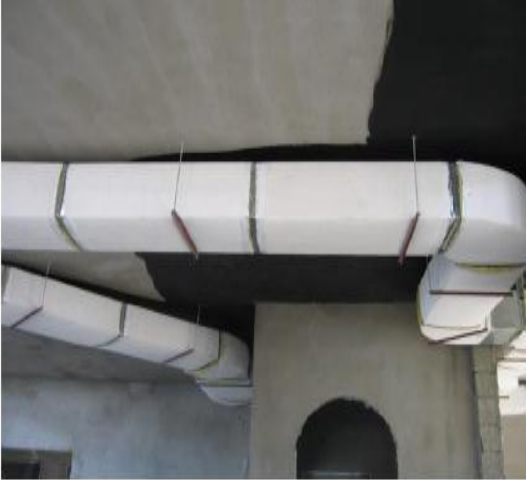
توصيله تكييف A/C duct
