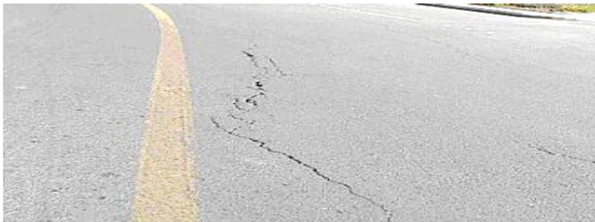
الشكل رقم (٦٠) يوضح شدة منخفضة للشقوق الجانبية
