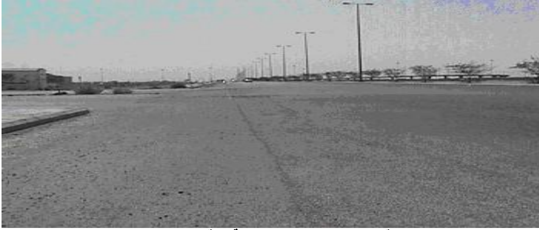
الشكل رقم (٨٣) يوضح شدة منخفضة لرقع حفريات الخدمات
