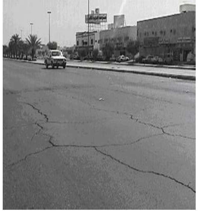
شكل رقم (٢١) يوضح شدة منخفضة للشقوق الشبكية
