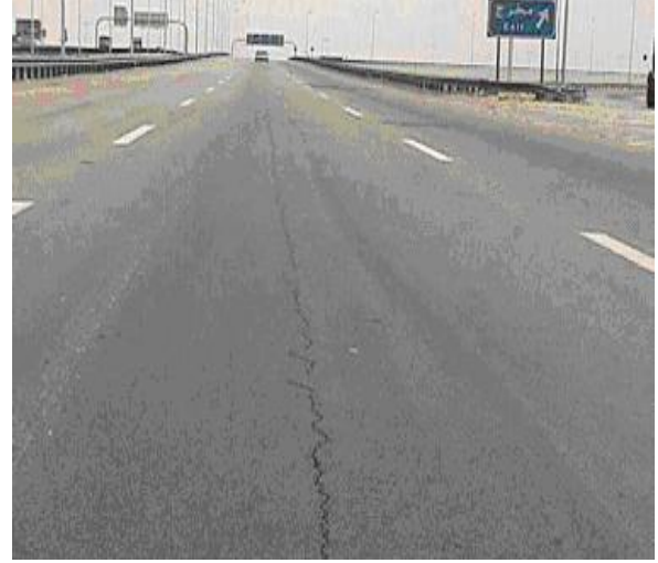
شكل رقم (٢٥) يوضح شدة منخفضة للشقوق الطولية
