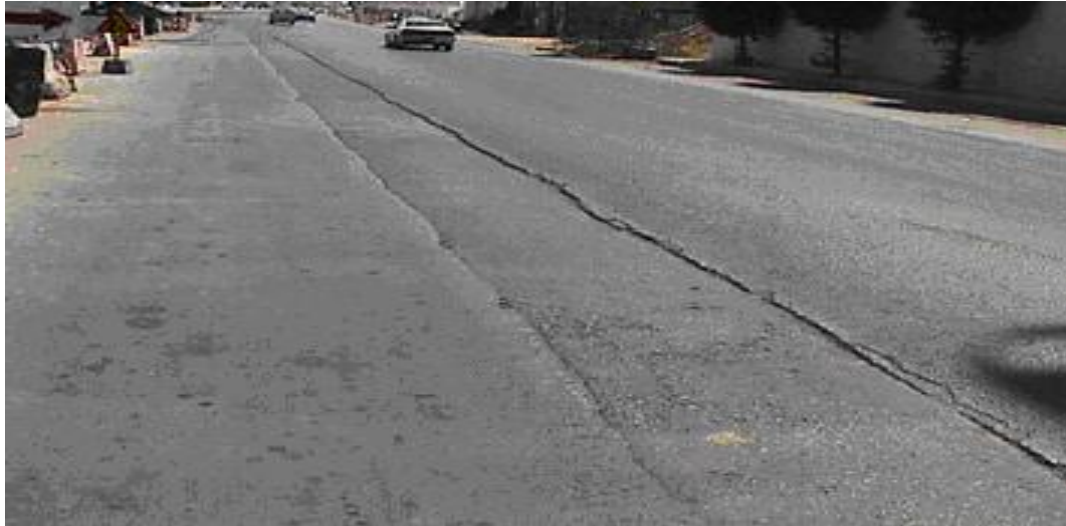
الشكل رقم (٨٥) يوضح شدة عالية لرقع حفريات الخدمات
