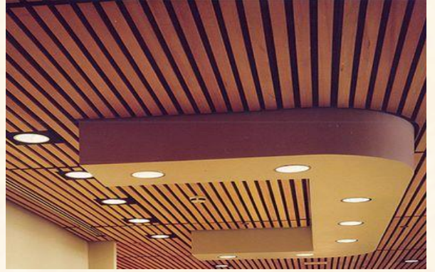
استخدام التكسيات الخشبية في الاسقف اعلي الكاونتر
