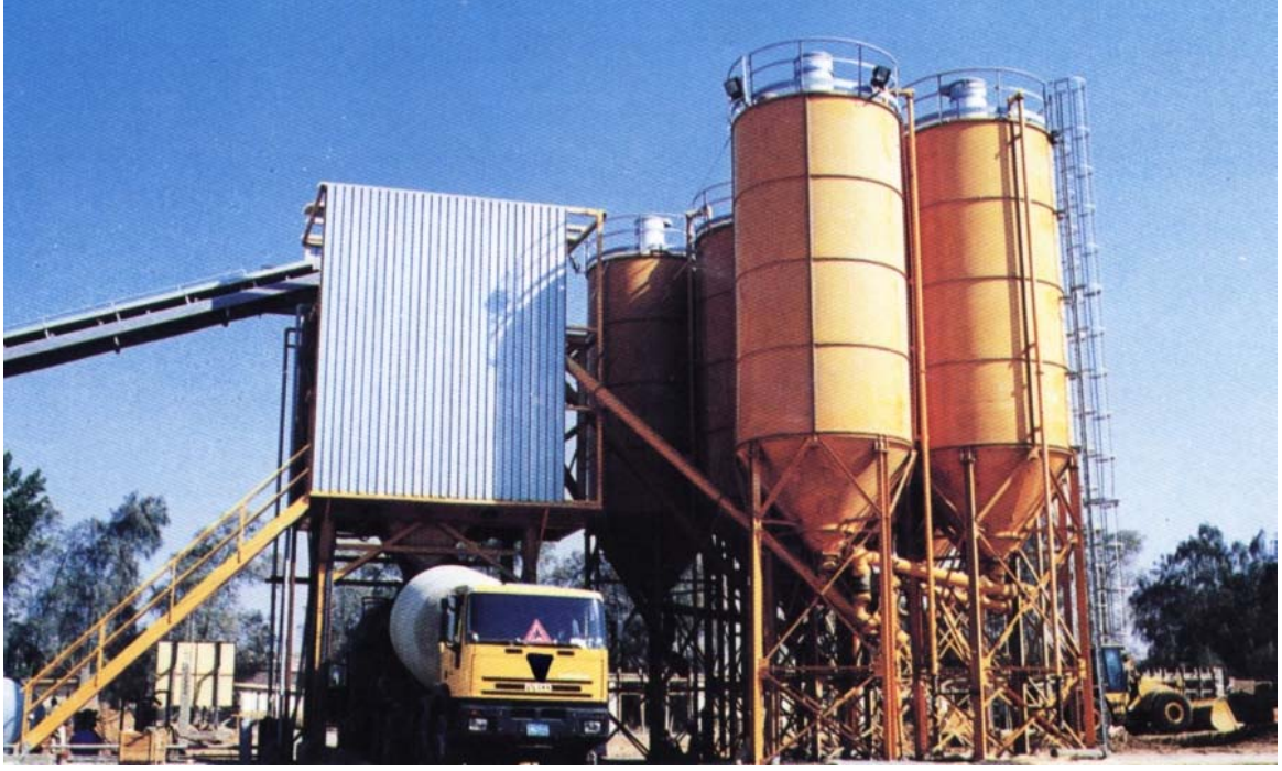
شكل (٤-١) محطة خلط مركزية لإنتاج الخرسانة.
