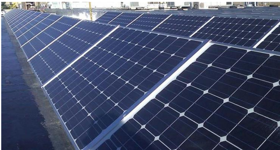
الخلايا الشمسية فى المبنى
