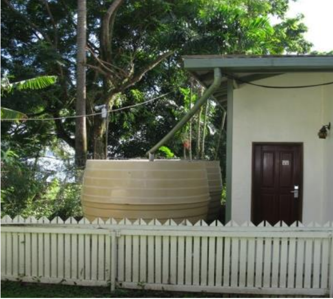
خزان مياه الامطار
