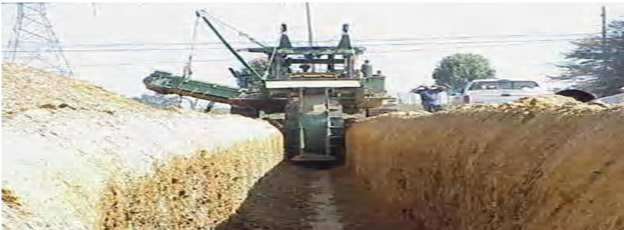
الشكل رقم (٧١) يوضح خط أنابيب التخندق
