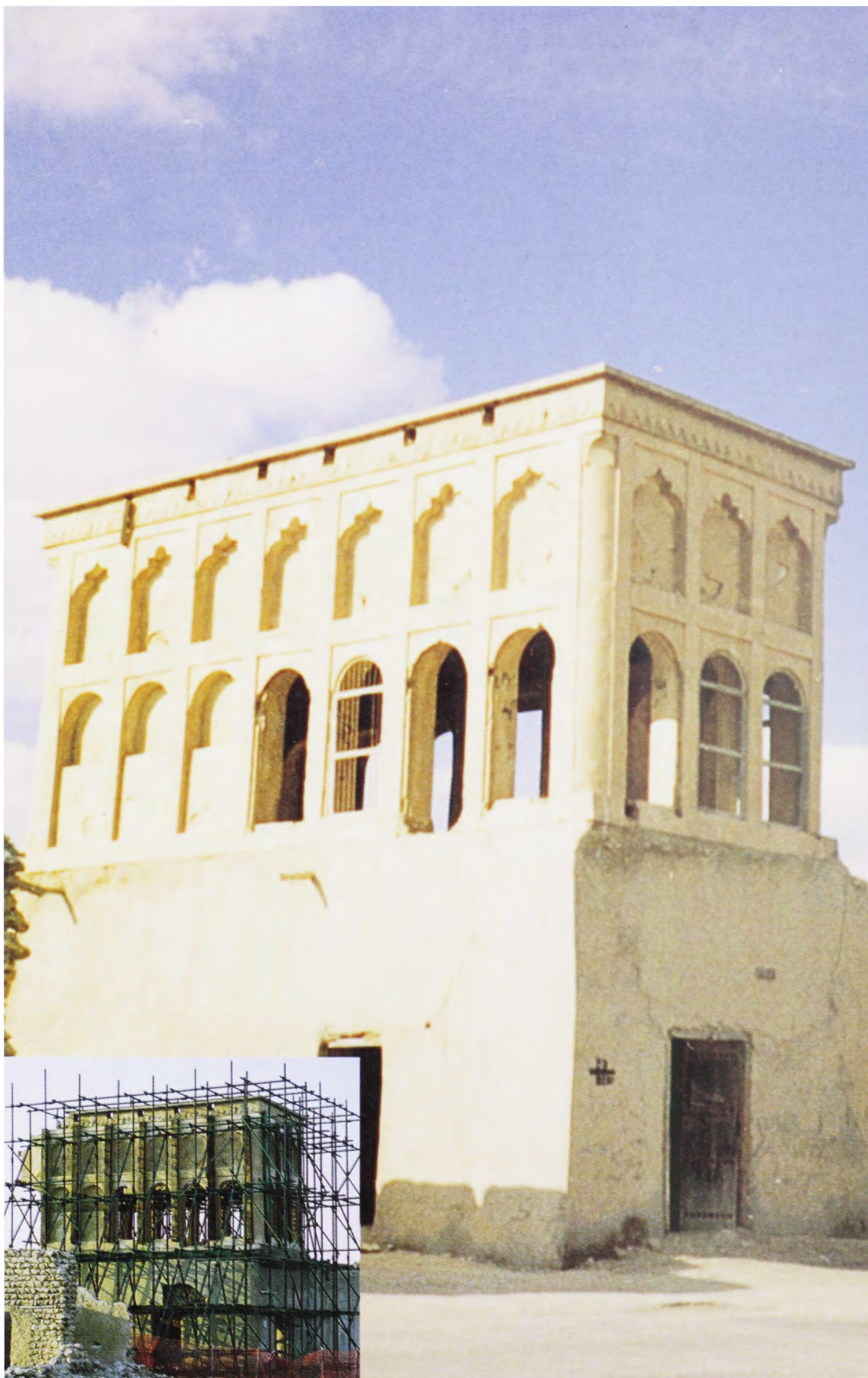
(شكل رقم ٥٦) الغرفة العلوية ذات الدخلات الجدارية التي تمتاز بها بيوت الوكرة وصورة أخرى توضح أعمال التدعيم تمهيدا للترميم.
