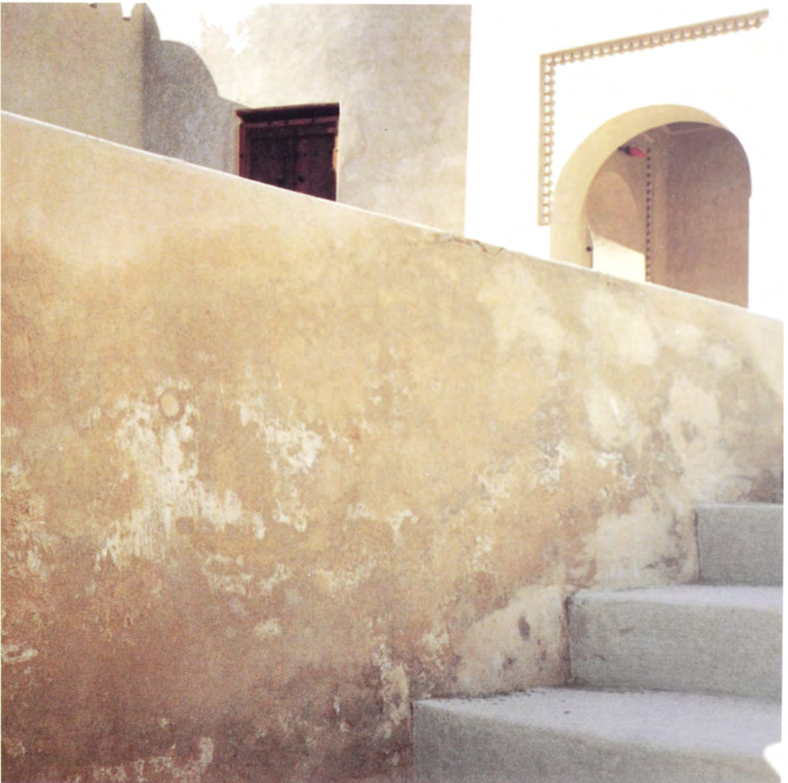
(شكل ١١٥) جدار مجدد لمبنى قريب من شاطئ البحر وقد بدأت آثار الرطوبة على سطح الجدار.
