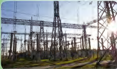
محطة توليد كهرباء شمال القاهرة
