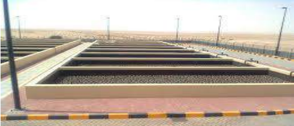
شكل (٩-٨): أحواض تجفيف الحمأة
