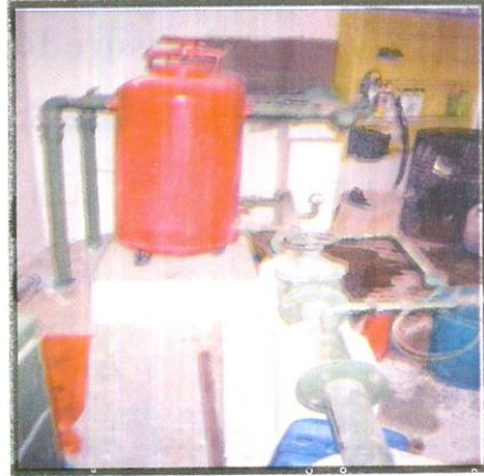
وحدة المرشحات الوسطية (رملية) لشبكة ري بالتنقيط (عدد ٢ مرشح) وتستخدم للمياه السطحية ( مياه الأنهار - التررع - الخزانات المكشوفة )
