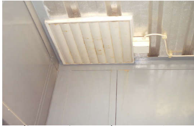
شكل رقم (٢٢٨) مروحة شفط الغاز في سقف الغرفة
