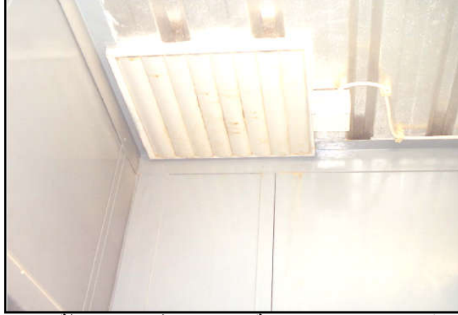
شكل رقم (٢٥٥) يوضح مروحة شفط الغاز في سقف غرفة التبخير
