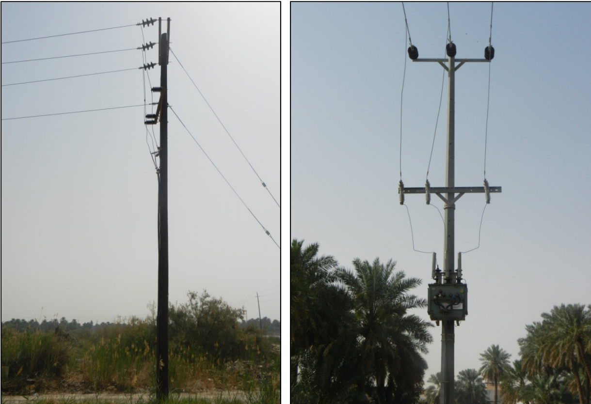
شكل (١- ٣٢) - برج النهاية لخط نقل كهربائي 13.8 kV
