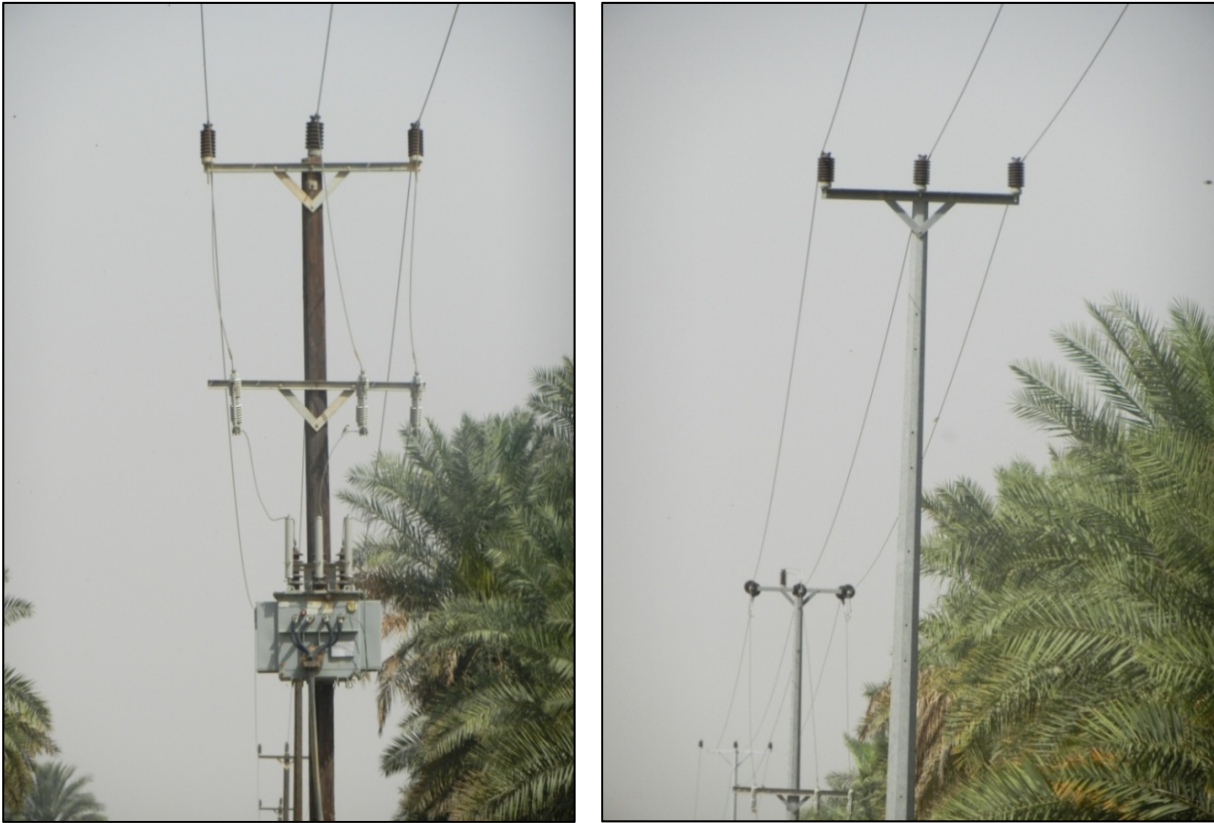
شكل (١ - ٢٨) - برج تثبيت 13.8 kV على خط نقل كهربائي
