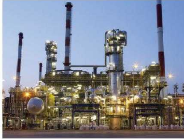
محطة توليد الكهرباء في الجبيل
