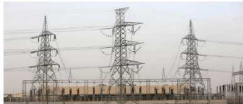
محطة سدير لتحويل الكهرباء
