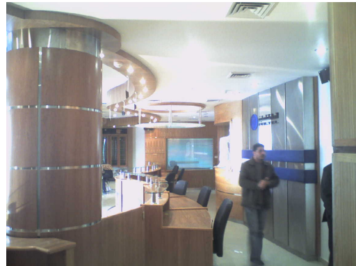
صورة توضح موزعات الهواء Diffusers و جريلات سحب الهواء في ممرات الشركة ، بشكل يتناسب و التصميم الداخلي للشركة
