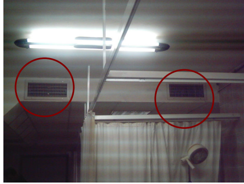
صورة توضح فتحات موزعات الهواء ( فتحات جانبية من Fall Ceiling )
