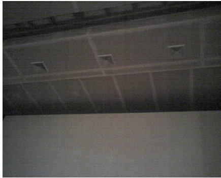
صورة توضح ضخ الهواء في منطقة stage عن طريق 5 Diffusers
