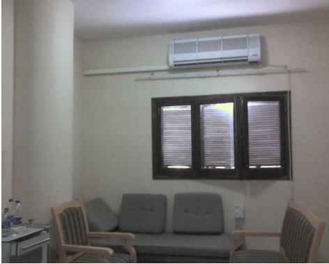
وحدة التكييف المنفصلة في منطقة الاستقبال في غرفة نوم المرضى ( Indoor )
