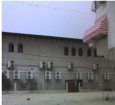
صورة توضح الوحدات الخارجية Outdoor الموضوعة على الواجهة الخلفية للمبنى
