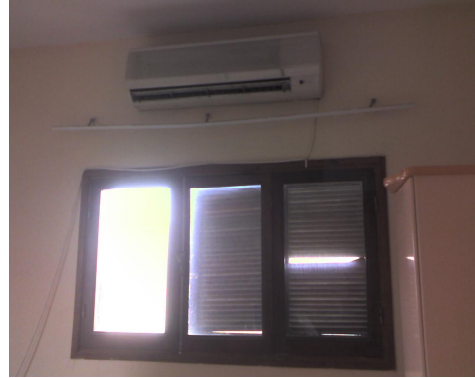
وحدة التكييف المنفصلة في منطقة نوم المريض ( Indoor )
